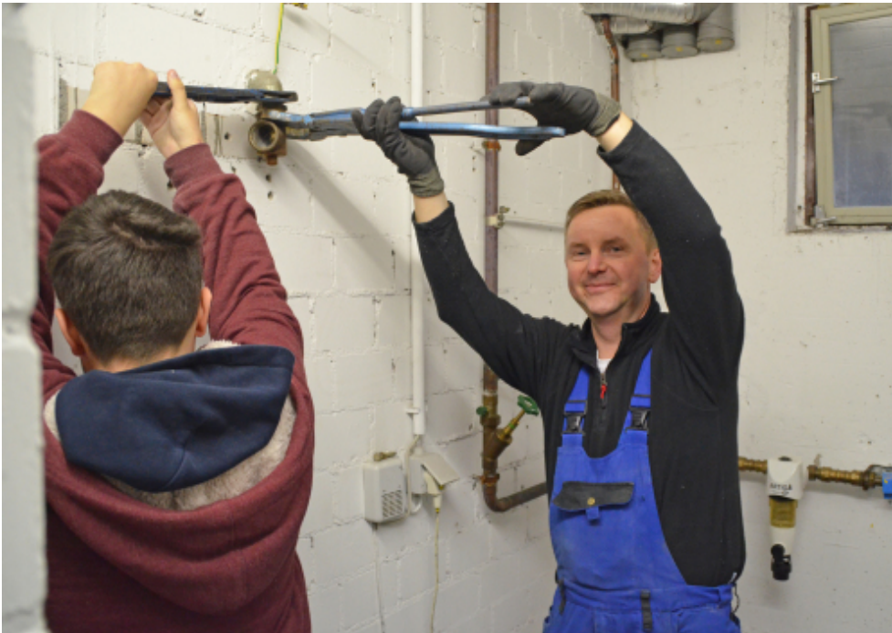
Thomas Meyrahn (Ziess Sanitär- und Heizungstechnik, r.) wird bei der Arbeit von Tagespraktikant Timon unterstützt. (Foto: OBK) Link auf Original-Bild
